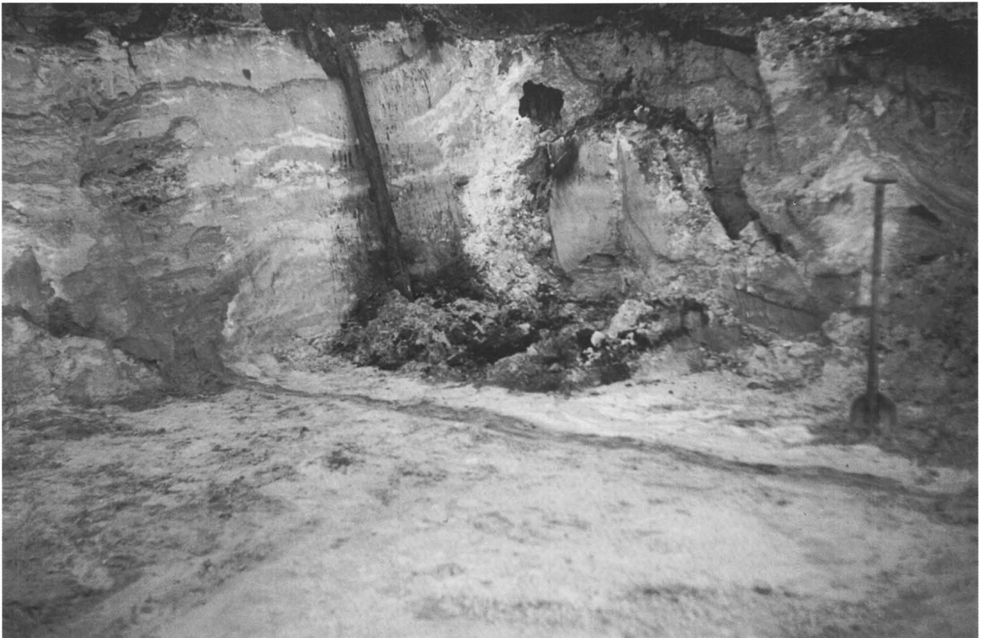
Afb. 4. Vorstwig in de noordelijke wand met zijn voortzetting in de bodem van de bouwput.
