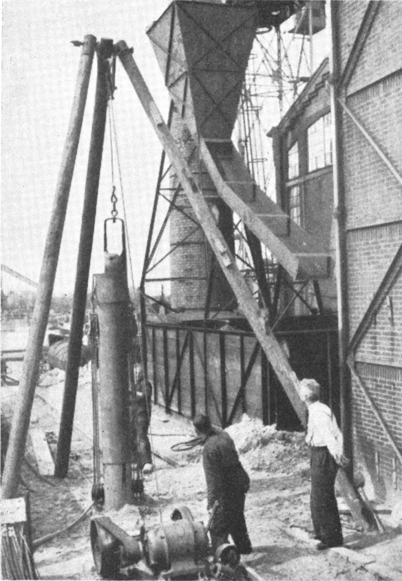
Afb. 126. Putboring op fabrieksterrein; de puls met een nieuwe vracht aan verrassingen is juist omhoog gehaald.
