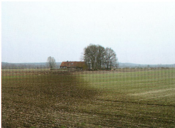
Afbeelding 9. Een in het midden van de vorige eeuw gebouwde boerderij even ten oosten van Asenray rechts van de weg naar de Duitse grens. De boerderij is boven op de Peelrandbreuk gebouwd en de westkant van de boerderij is door beweging van de breuk verzakt. In het bouwland aan de kant van de slenk is de aarde donkergekleurd door kwelwater. Vanaf de weg is de boerderij goed te zien.
