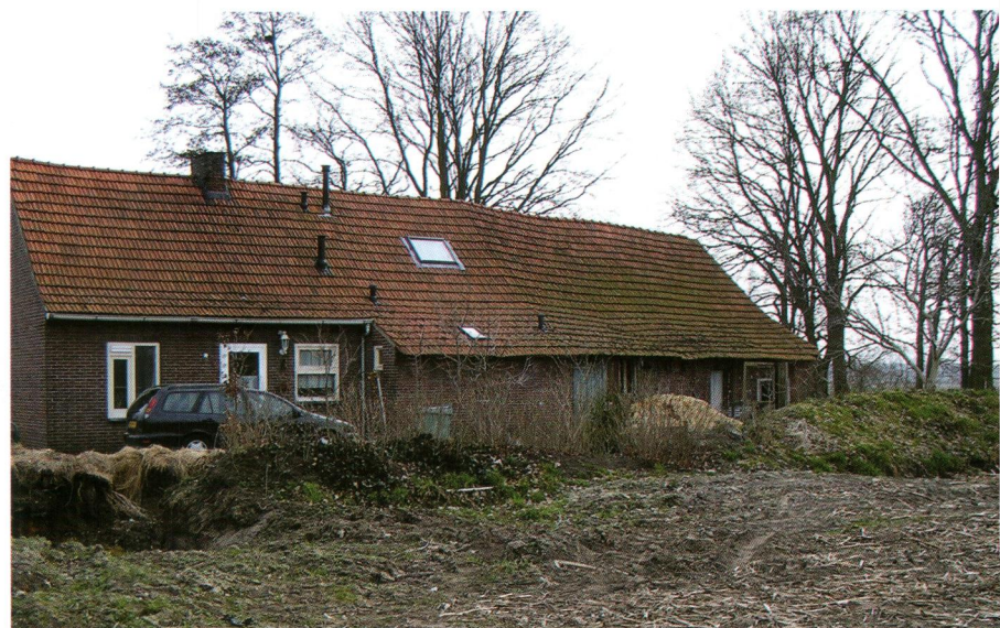
Afbeelding 10. Het verzakte dak van de boerderij ten oosten van Asenray.
