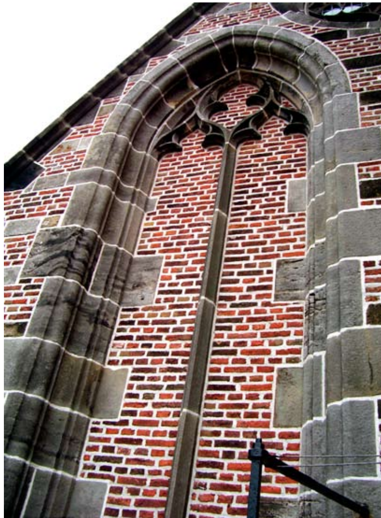
Afb. 9. Tracering in Bentheimer zandsteen rond dichtgezet raam in de west-gevel van de Pieterskerk (apr. 2007)
