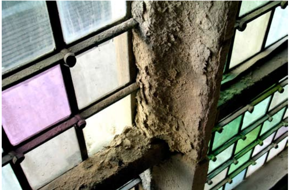
Afb. 23. Sterk verweerd en inmiddels verwijderd montant van Morley kalksteen in de westgevel van het zuidtransept van de Pieterskerk (okt. 2003).
