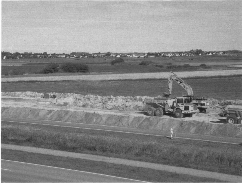
Werkzaamheden bij het Hegewiersterfild, met op de achtergrond de bebouwing van Harlingen.
