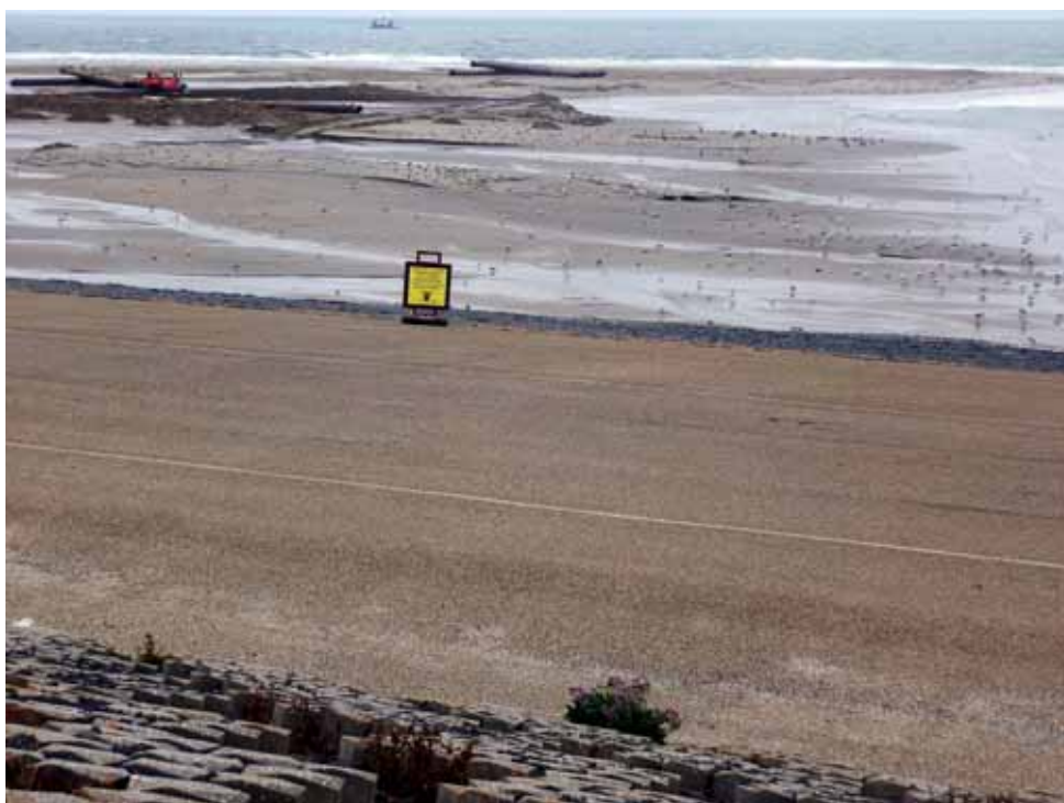
De geasfalteerde strook en stenen aan de zeezijde van de Zeewering raken bedolven onder oprukkend zand, juli 2014.
