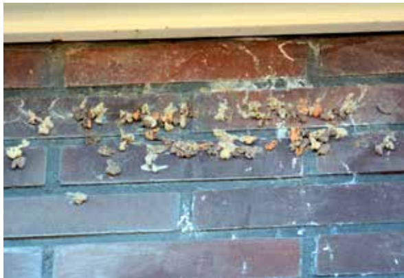
Figuur 10. Verschillende soorten keileembolletjes op de muur geplakt.
