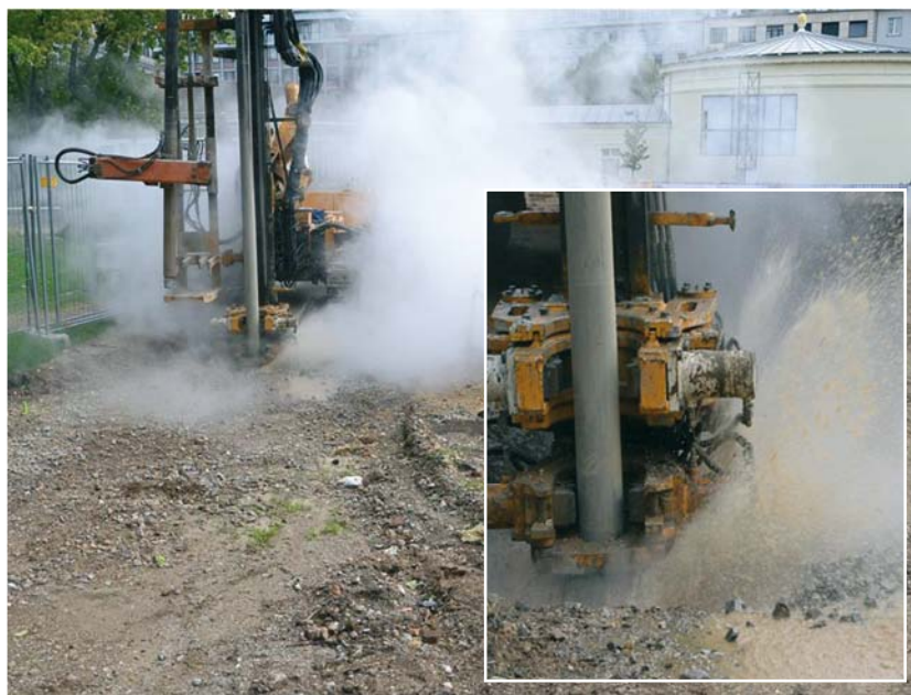
AFBEELDING 8. | De “nep” warmwaterbron die tijdens boorwerkzaamheden ontstond. Op de achtergrond het paviljoen van de Elisenbrunnen.
