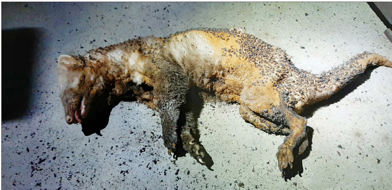
▲ De Hoogspanningsmarter ( Martes foina ) zoals aangetroffen op de vloer van het 150 kV-onderstation Borculo aan de Hesselinks Es in Borculo, 12 januari 2021. (Leon Hoogerdijk, Qirion)
