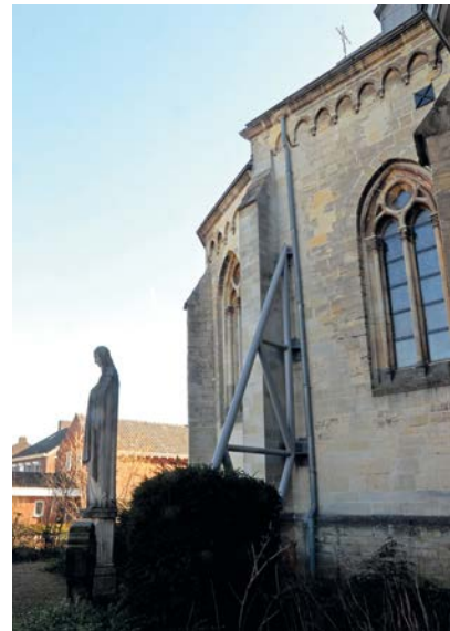
AFBEELDING 2. | De St. Sebastianuskerk van Herkenbosch. Bijna helemaal herbouwd na de zware oorlogsschade in 1945, gerestaureerd na de aardbevingsschade van 13 april 1992. Het uit de dertiende eeuw daterende Romaans priesterkoor kon behouden blijven. De noordelijke muur, die bij de aardbeving kwam scheef te staan, wordt gestut door een constructie van stalen buizen. (eigen opname)
