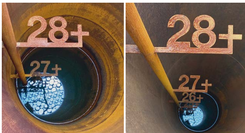
AFBEELDING 3. | De twee buizen met grondwaterplaats bij de boerderij van Henk Kerkers. Foto: Willem Terpstra
