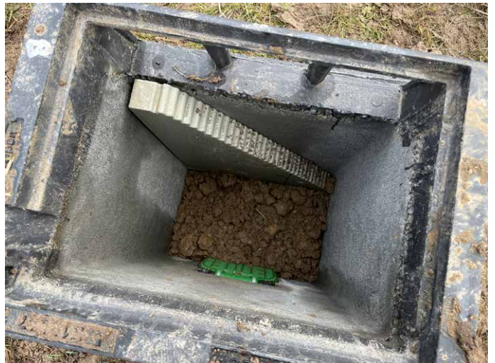
De betontrap (Haagse trap) vermindert de waterafvoerende capaciteit van de trottoirkolk. (Foto: Raymond Creemers)
