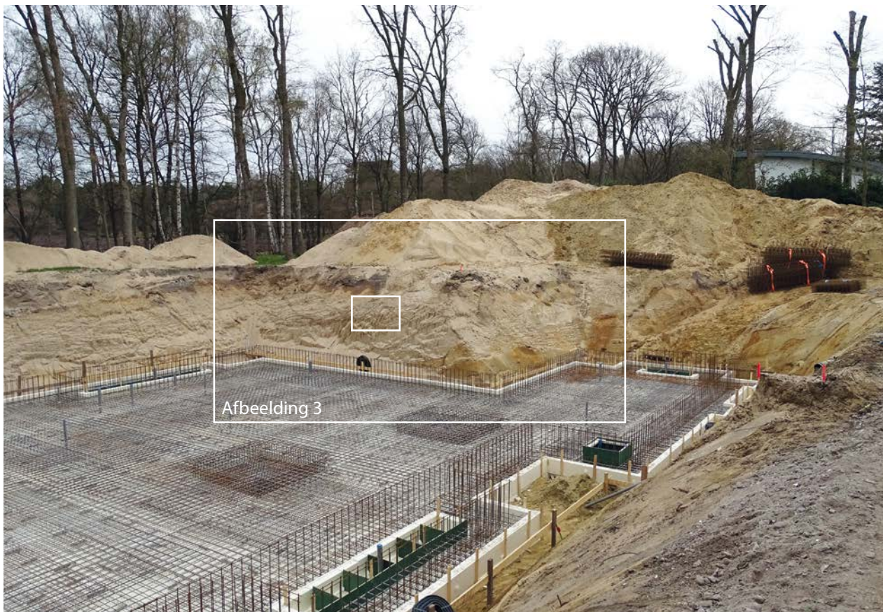
AFBEELDING 2. | Overzichtsfoto van de bouwput aan de Grintbank, kijkrichting noordoost. Het grote kadertje in de foto markeert Afbeelding 3, het kleine kadertje Afbeelding 4. Foto: Sander Koopman.
