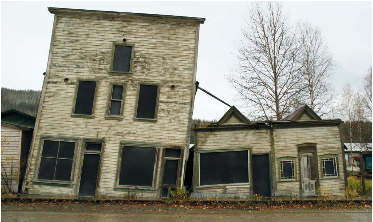
AFBEELDING 6. | Deze bouwwerken werden gebouwd tijdens de goudkoorts van 1896-99 in de Yukon en stortten nu in door de ontdooiende permafrost. Foto: Terry Feuerborn, CC BY-NC 2.0, via Flickr.
