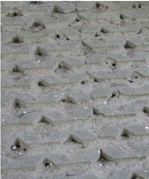
Een detail van de betonelementen op het talud onder de brug, waarin gaten zijn uitgespaard. In bijna elk gat zijn één of meerdere nestopeningen van de Gewone Sachembij zichtbaar. Foto: Frans van Alebeek,
