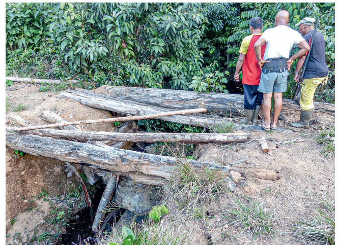
▲ Afb. 2. Deels ingestorte brug in een voormalige bauxietexploratieweg in het Bakhuisgebergte. Hier konden wij met onze 4WD niet verder rijden. Foto: Frank Beunk.
