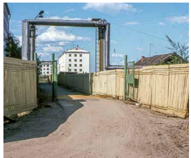
▲ Afb. 9. Utilidor (bovengrondse leidingenstraat) om schade van ontdoende permafrost op ondergrondse leidingen te voorkomen; hier over een weg geleid.
