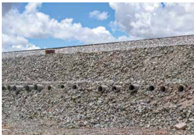
▲ Afb. 10. Ophoging met grove steenslag om verzakkingen van een weg door permafrostdooi te voorkomen. Foto: J. Vandenberghe.
