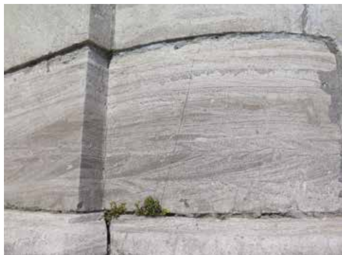
▲ Afb. 14. Hoekketting in bleekgrijs gepatineerde oölitische kalksteen (Steen van Vinalmont) met duidelijke kriskras gekruiste gelaagdheid. Stadhuis van Sint-Truiden. Ouderdom: Midden-Viséaan (Onder-Carboon).
