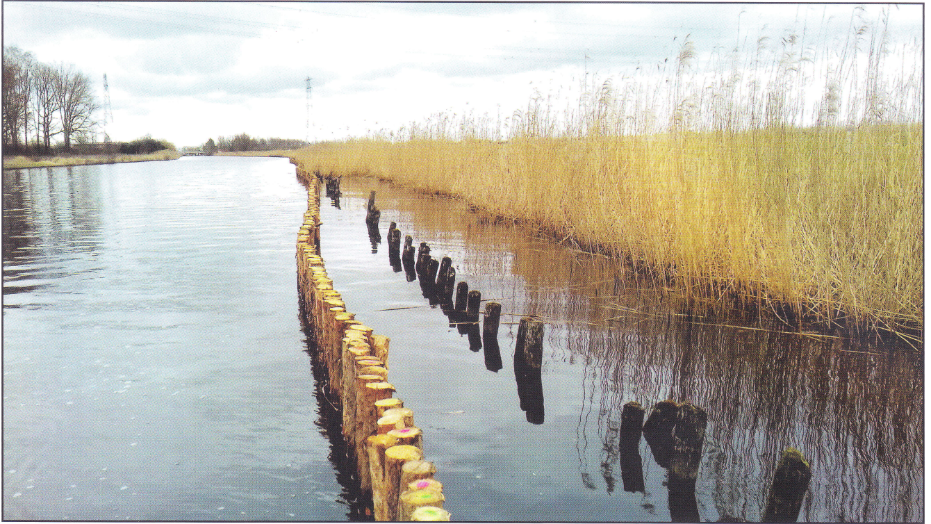
Figuur 2. Achterstallig onderhoud Stoppelsoal met een vrijwel gesloten natuurvriendelijk, nieuw palenscherp in de oorspronkelijk aangelegde natuurvriendelijke oever die in 2020 opnieuw ingericht werd als zogenaamde KRW natuurvriendelijke oever. Het riet zal daarna nog weggegraven worden. Zicht ter hoogte van Elektriciteitscentrale in noordelijke richting (Zwartkruis), 20 september 2021 (foto zie figuur 1).
