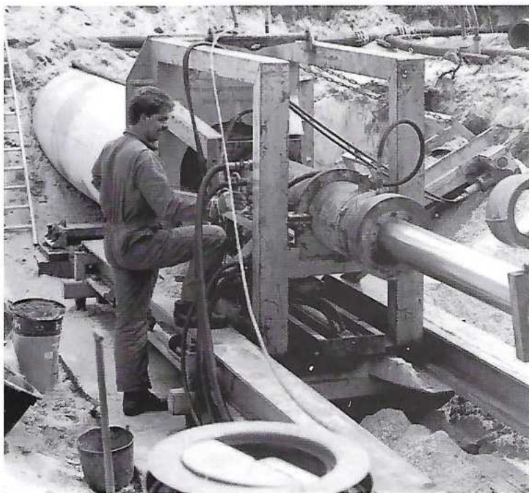
Door de stormvloedkering is een duiker geperst (foto: Pieter de Vries).
