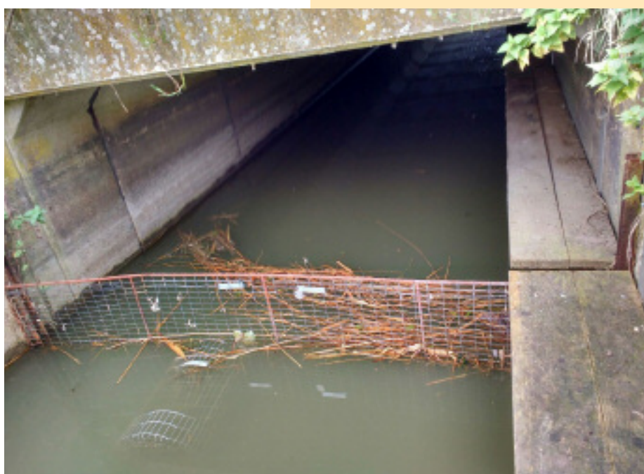
Looprichel over afsluitende fuik in een duiker onder een weg. Foto Daan Bos
