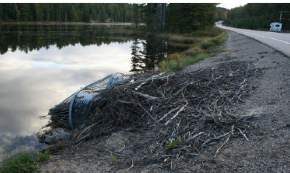
Afwateringspijp in Canada beschermt tegen afsluiting door bevers. Foto Jon Coosen.
