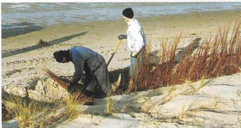
Klassiek zeeweringbeheer op Schouwen, het inplanten van schermen om het zand vast te houden (foto: Moniek Löffler).
