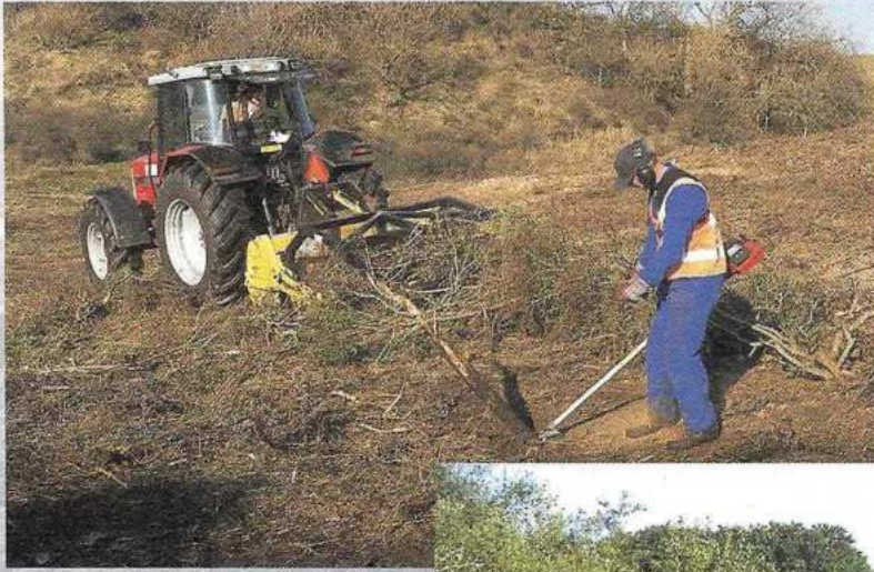
Voordat de humusrijke grond kan worden afgegraven bij natuurherstelprojecten moet het struikgewas worden gekleemd, zoals hier in het Kraansvlak in Overveen (foto: Henk Wijkhuisen).
