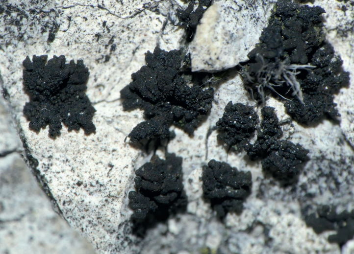
Figuur 1. Habitus van Scytinium callopismum (navelzwelkorst) op de betonnen muur op de Hoge Veluwe. Deze exemplaren zijn goed ontwikkeld met duidelijke randlobben.
