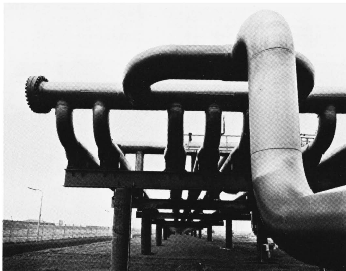
In Den Helder bevindt zich de behandelingsinstallatie voor het Noordzeegas. Hier een van de markante onderdelen, de zo geheten 'slokkenvanger'. (Foto NAM)
