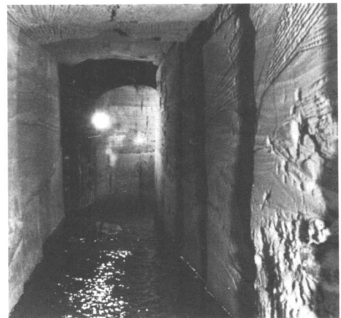
Fig.5. Wingalerij bij pompstation Heytgracht (Valkenburg).
