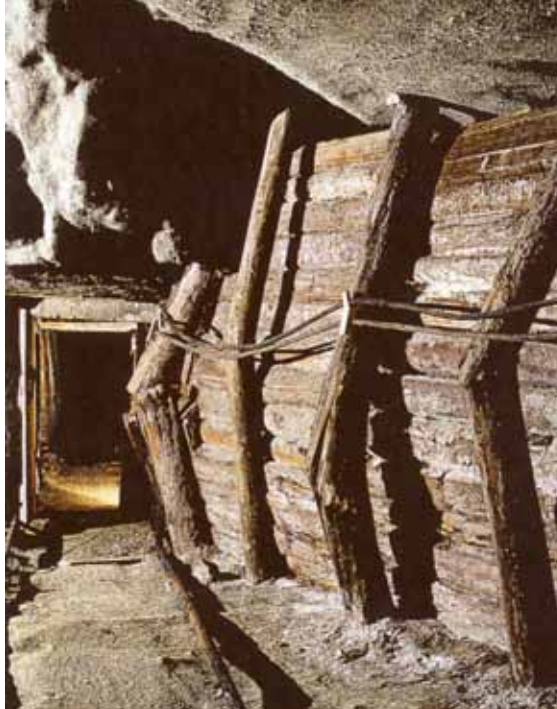
Afb. 11. De mijn is onderhevig aan de krachten van de aarde. De betimmering barst onder de druk van de gesteentemassa en moet ongeveer om de tien jaar worden vervangen. Bron: Podlecki, 2001.
