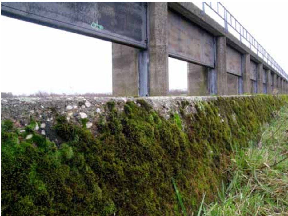
Figuur 3. De keermuur in het westen van de Meinerswijk (foto: Michel Zwarts).
