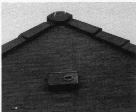
Gierzwaluwneststenen bij nieuwbouw in Amstelveen.
