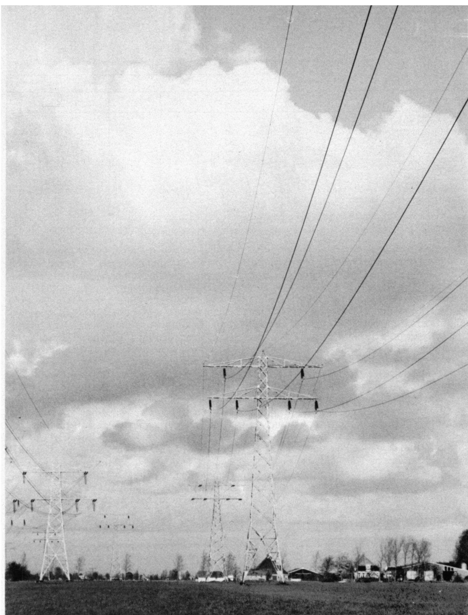
Figuur 2. De 110 kV-lijn (rechts) en de 220 kV-lijn (links) in de omgeving van Heerenveen. In de bliksemdraden 'grote krullen'. Foto: PEB in Friesland.
