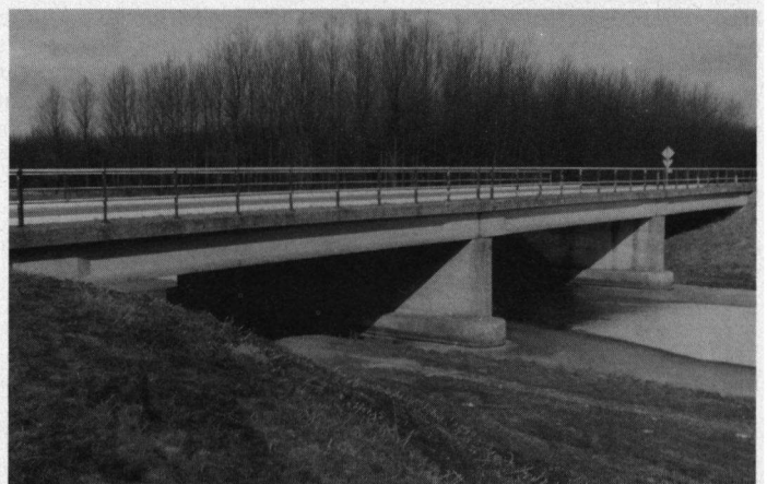
Brug Rietweg/Larservaart, de nesten bij deze brug bevinden zich verspreid over de gehele onderzijde van de brug. Uit vergelijking met de andere bruggen blijkt dat de nesten bij voorkeur op de balkonconstructie aan de onderzijde van de bruggen worden gebouwd, februari 1988. Foto: Rijkswaterstaat, Directie Zuiderzeewerken.
