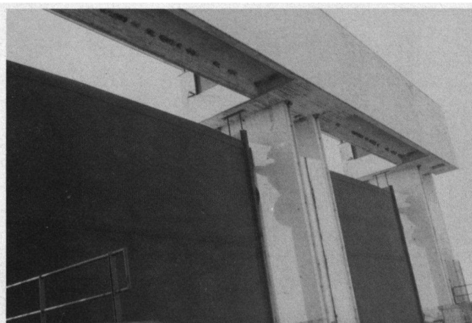
Hoge Knarsluis, bijna alle nesten bevinden zich aan de onderzijde van de bovenconstructie, februari 1988.
