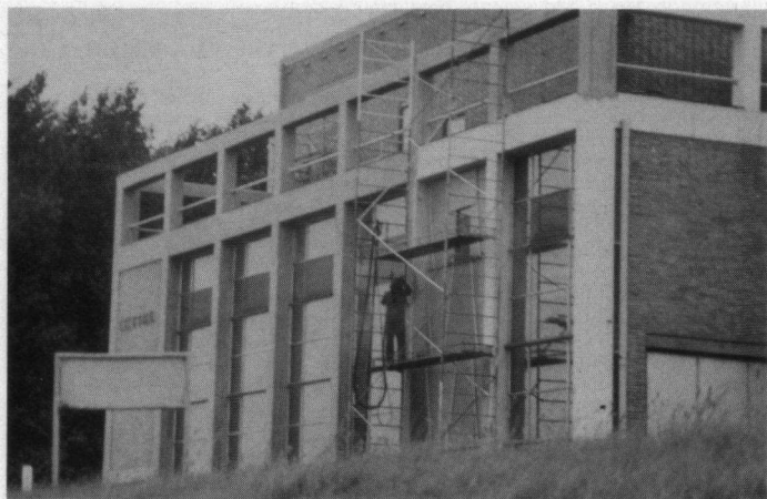
Het schoonspuiten onder hoge druk van het Gemaal Lovink waardoor 55 bewoonde huiszwaluwnesten verloren gingen, 25 augustus 1978. Naar een dia van Jelle Harder.
