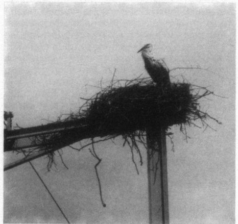
Het nest werd gebouwd op de uiterste punt van een spoorportaal. Foto: Hans Post.
