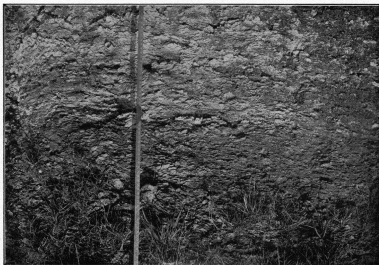
Fig. 24. Materiaal van den wierdijk aan de binnenzijde van den Nieuwlandpolder bij den Z.W.hoek.
