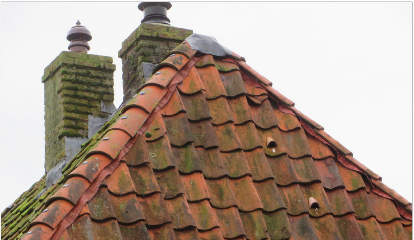
Figuur 3. Broedplaatsverlies en -behoud in Woudsend, juni 2013. Bij de rechter helft van het gesplitste pand zijn de nestingen met de rode keperstrips ontoegankelijk gemaakt. Bij de linker helft zijn de strips wat op gebogen en drie huifjespannen geplaatst. Rechts is uitgestorven, links wordt weer gebroed (foto Jaap Langenbach).
