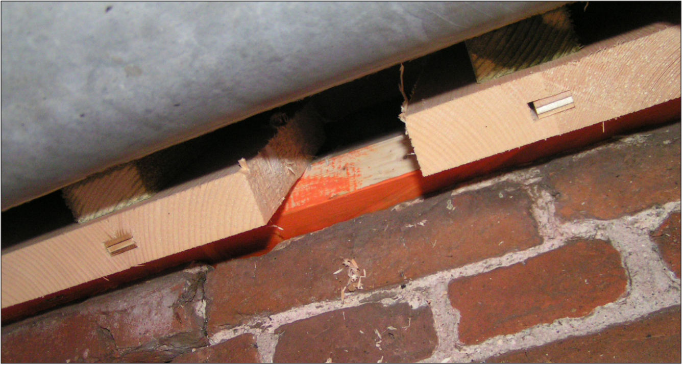
Figuur 4. Kerk Tjalleberd, december 2011. Nestingen, ontstaan door rotting van dakbeschot, zijn bij de vervanging behouden. Er wordt opnieuw op de (oranje) muurplaat gebroed (foto Jaap Langenbach).
