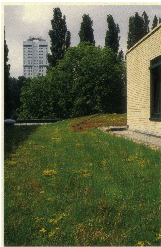
Voorbeeld van de toepassing van vegetatiematten op een plat dak. foto: Mosterd en De Winter
