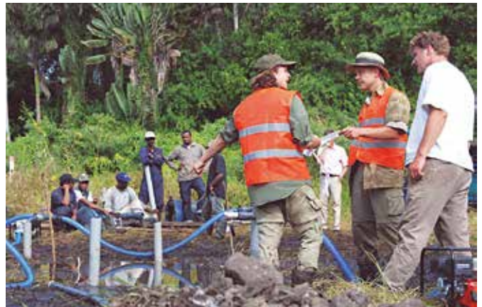
Afb. 7. Installatie pompputten rondom dodopolder (2007). Van links naar rechts: Perry de Louw, Kenneth Rijdsdijk en René Floore.
