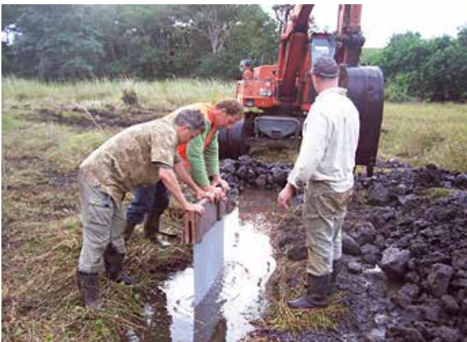
Afb. 6. Installatie van eerste damwand (aanleg dodopolder, 2007). Van links naar rechts: Kenneth Rijdsdijk, René Floore en Julian Hume.
