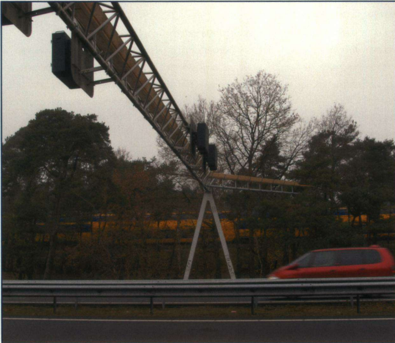
Een portaal met wegsignalering is geschikt gemaakt als boombrug. Foto: Erik Niewerf
