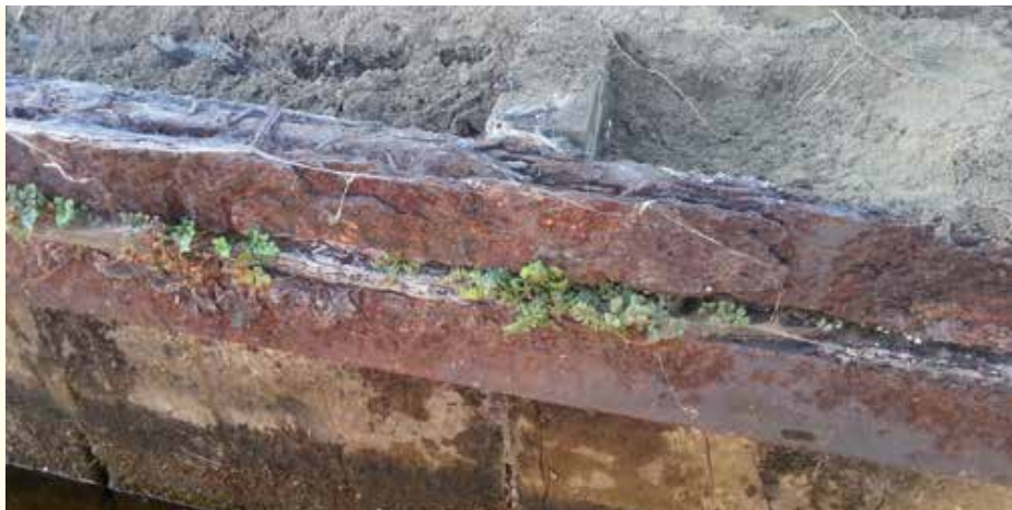
Kleine planten in de ijzeren balk. Aan de bovenzijde is te zien waar de zojuist verwijderde houten balk zat.
