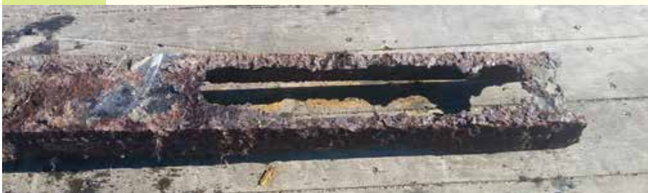
Zeer slechte staat van de ijzeren balk waar de Forez streepvarens in groeien. Dit betreft een loshangend, verwijderd gedeelte.
