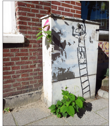
▲ Japanse duizendknoop doorgroeit een schakelkast in Delfshaven. (Remko Andeweg)
