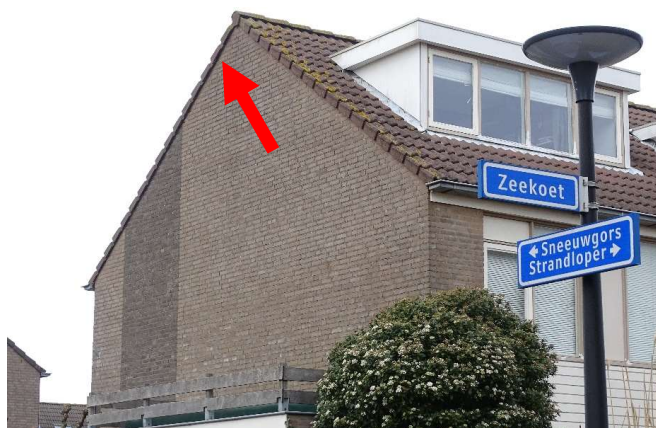
figuur 3. Huis in de wijk 'Vinkeveld'. Het dak is gedekt met dakpannen van het type 'sneldekker'. De pijl geeft de invliegplaats aan van Gierzwaluwen onder een kantpan in 2018
